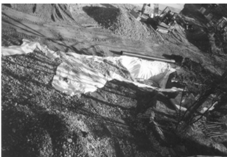
Rigolen zur Versickerung des Regenwassers auf dem Schulhof
